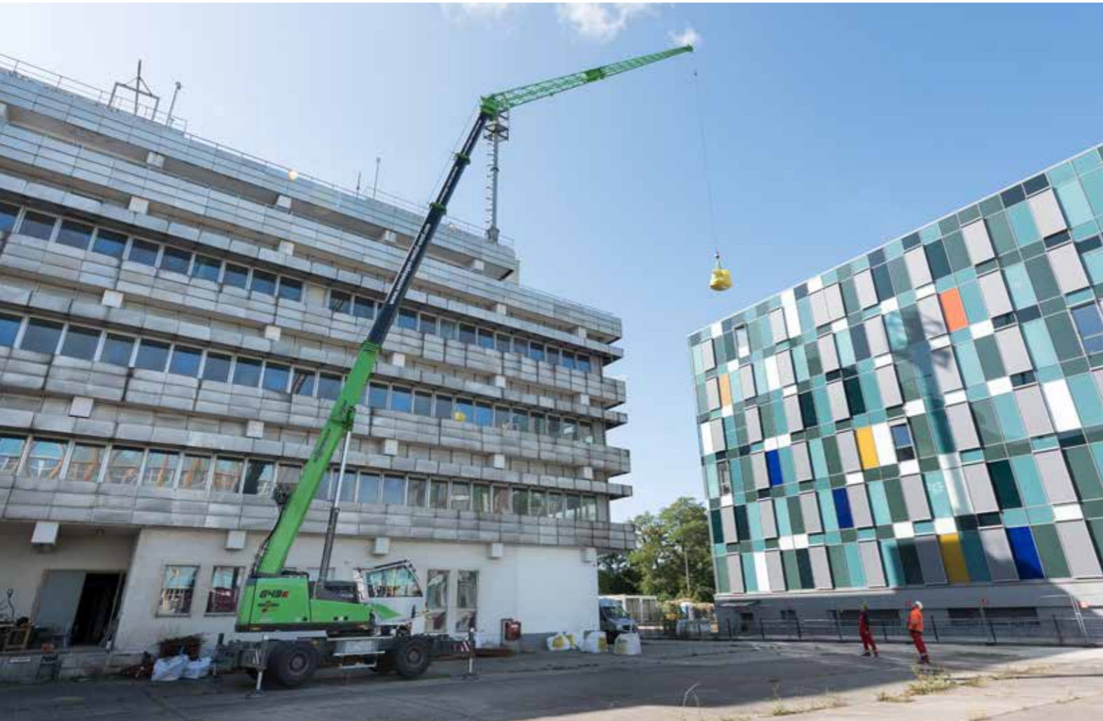
643 M - equipped with 13 m fly jib, in structural engineering; Germany 643 M - Hochbau mit 13 m Spitzenausleger; Deutschland
