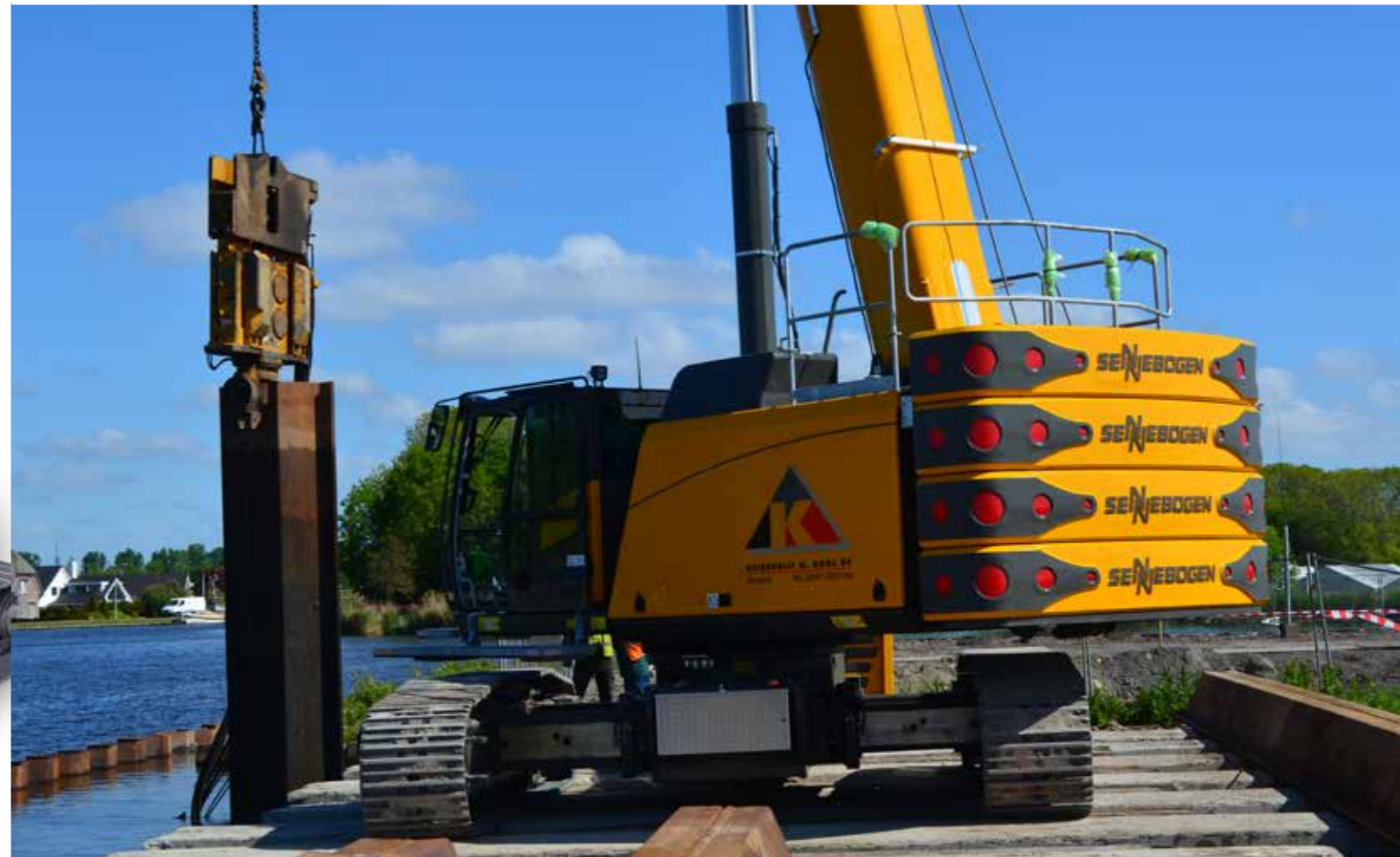
... and use the vibrator to install sheet piles; Hydraulic engineering; Netherlands ... und bringt mit dem Rüttler Spundwände in den Boden ein; Wasserbau; Niederlande
