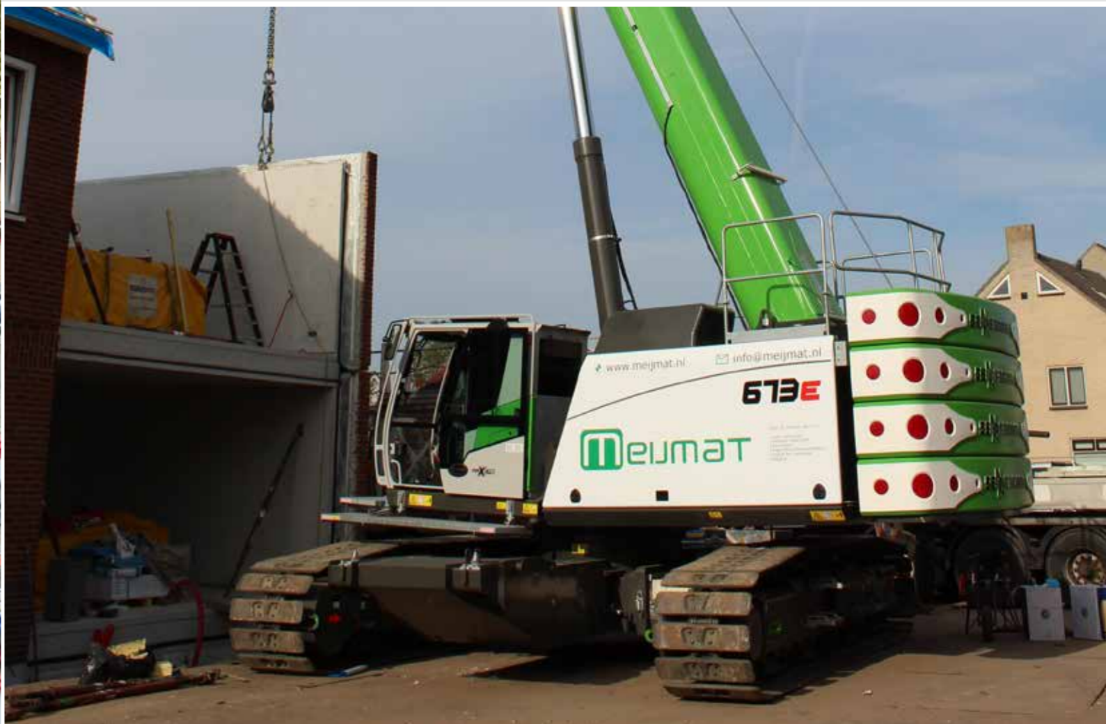
673 R - lifting heavy precast concrete elements; Netherlands 673 R - verhebt schwere Betonfertigteile; Niederlande
