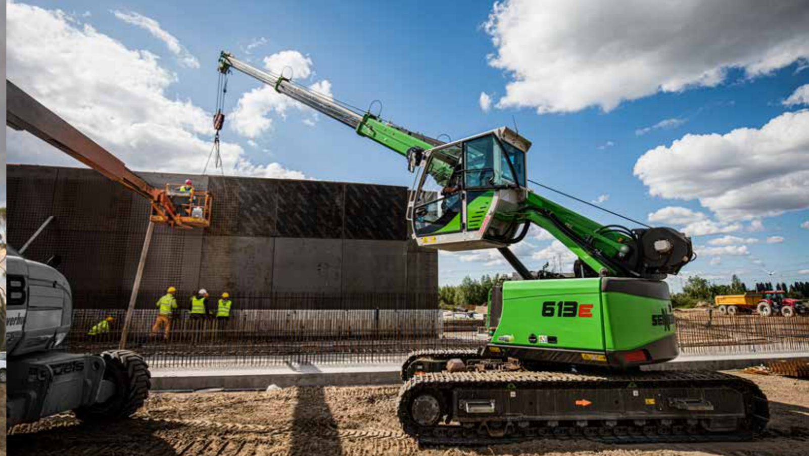
613 R - installation of concrete steel mesh; Belgium 613 R - Befestigung von Betonbewehrungsmatten; Belgien
