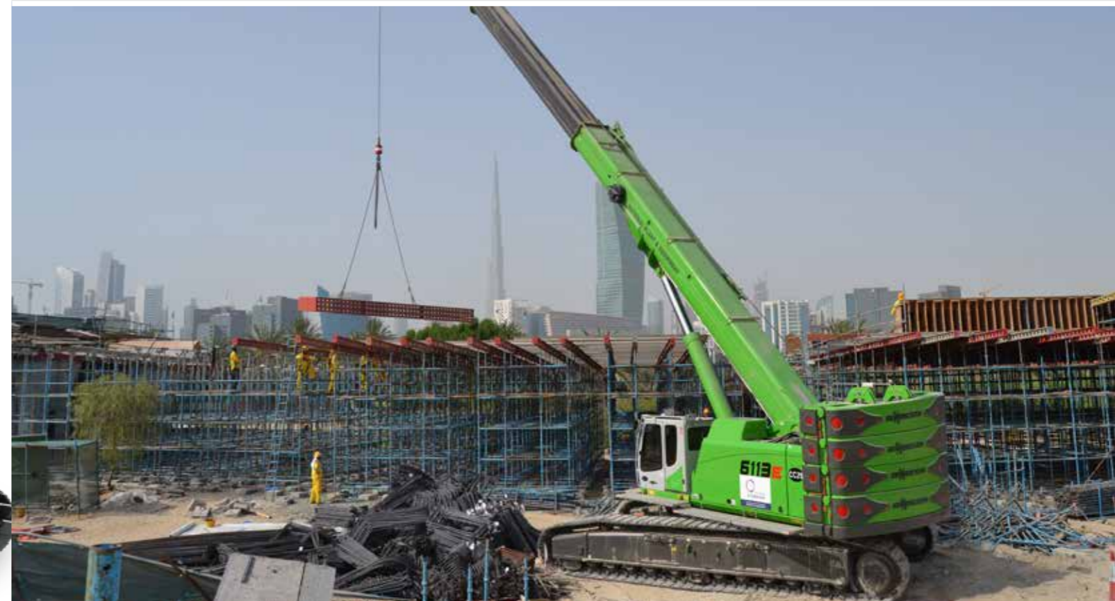
6113 R - in use on large construction sites in various lifting applications; Dubai 6113 R - auf Großbaustellen in diversen Hebeeinsätzen im Einsatz; Dubai
