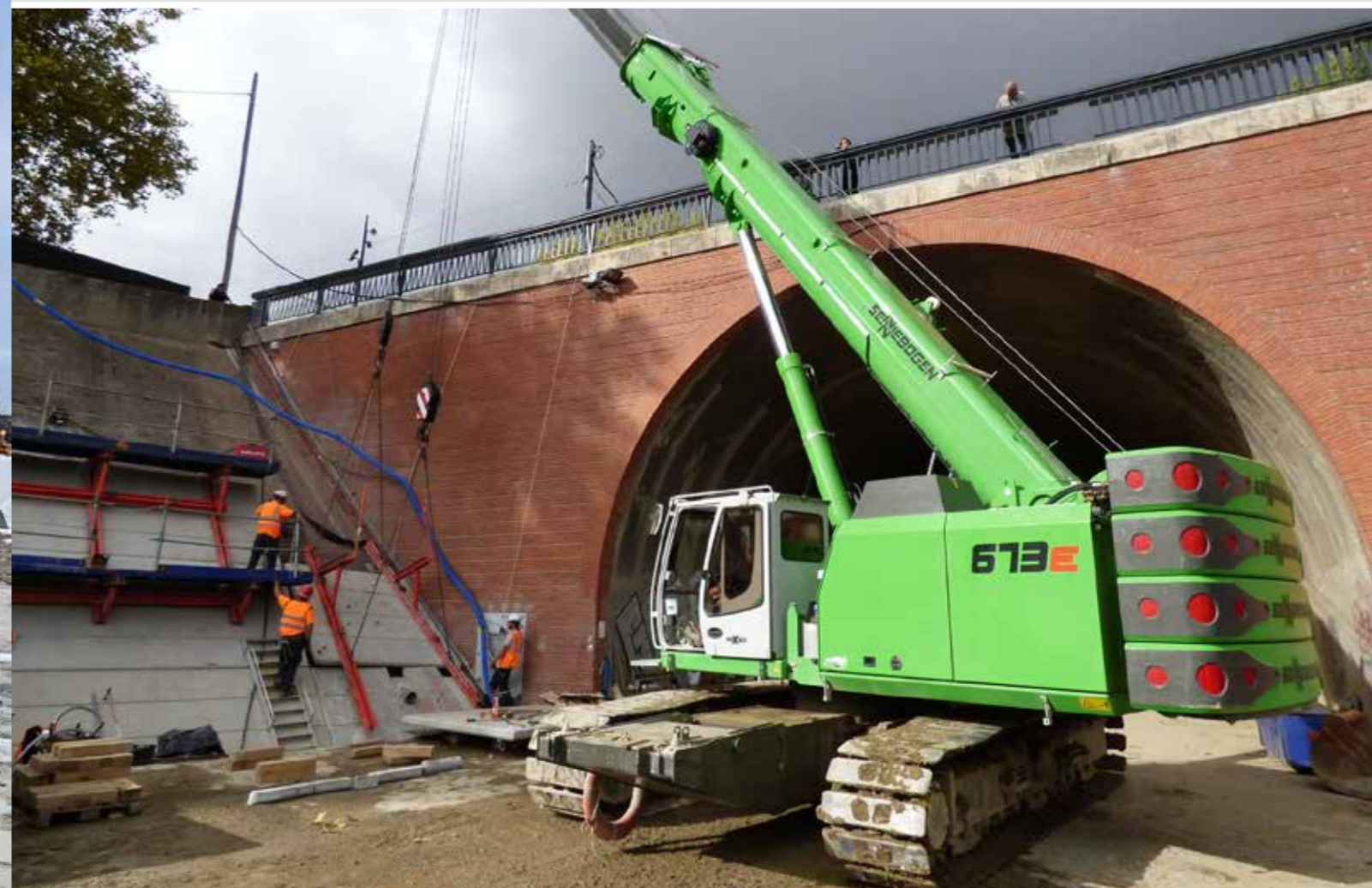
673 R - precise pick and carry operation, even in a confined construction site environment 673 R - präzise Pick and Carry Aufgaben, auch in beengter Baustellenumgebung
