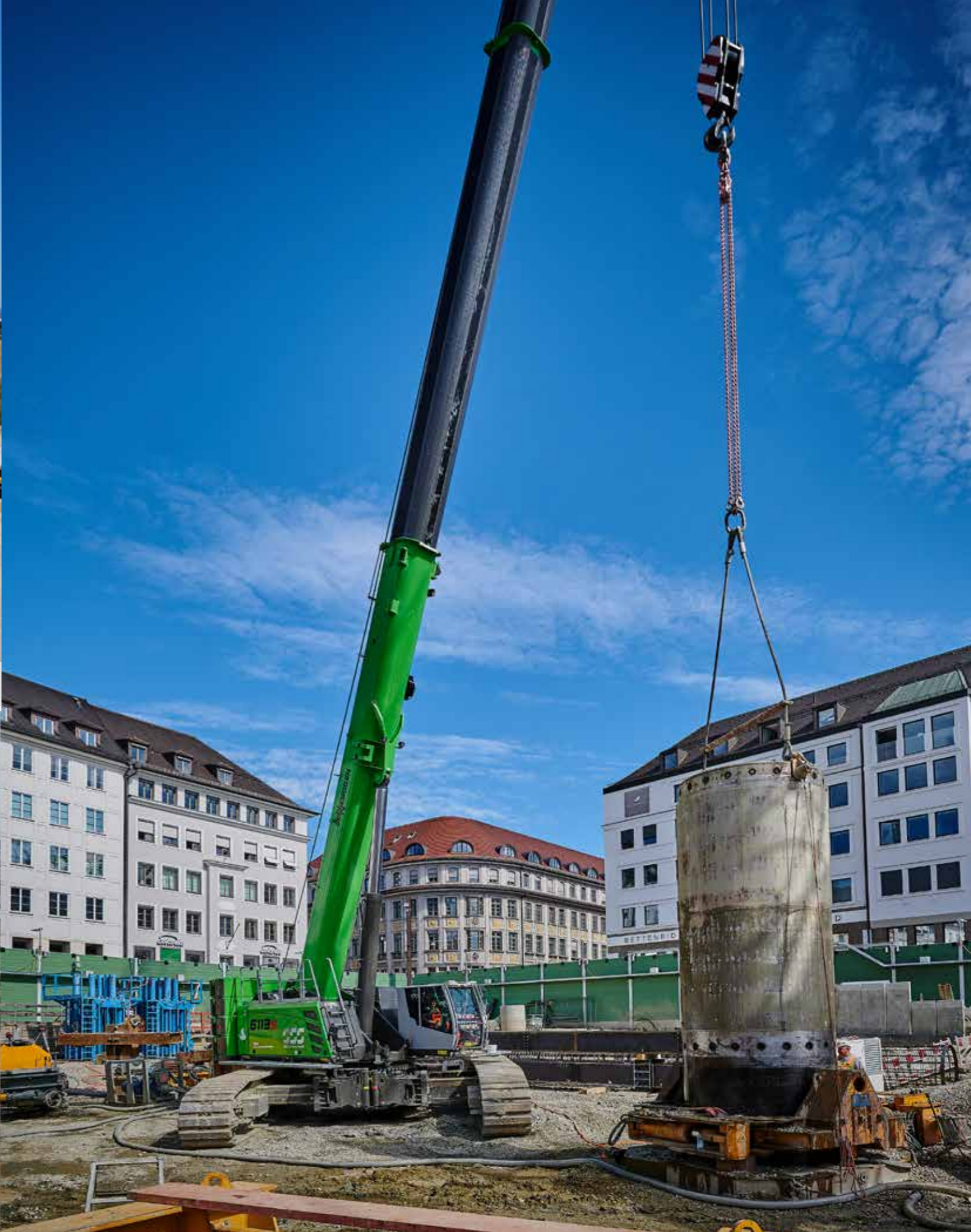
6113 R - Drilling work in specialized civil engineering; Germany 6113 R - Bohrungsarbeiten im Spezialtiefbau; Deutschland
