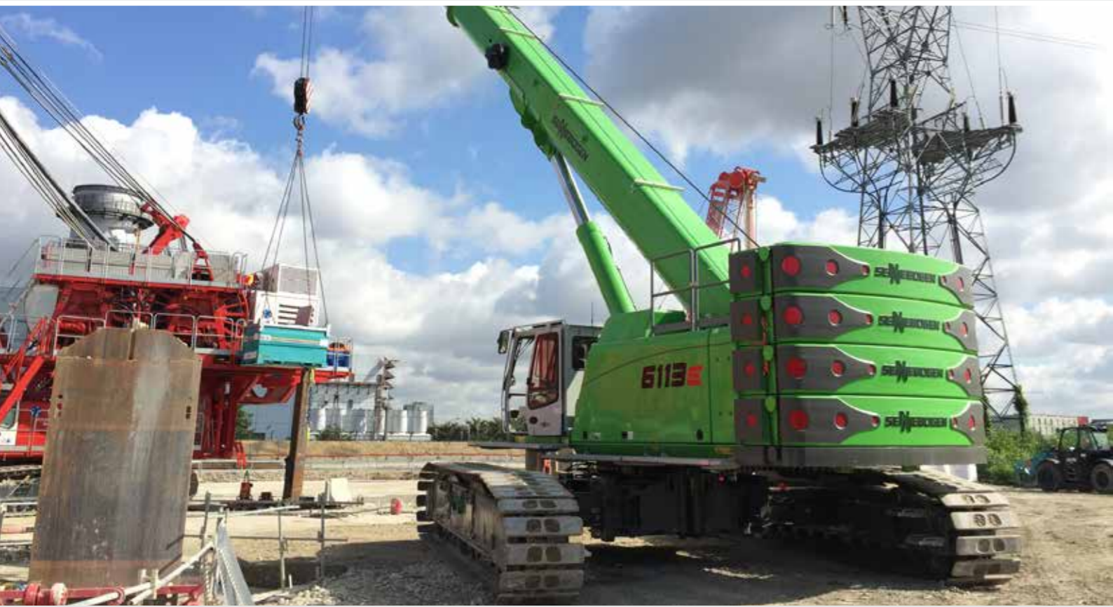
6113 R - as auxiliary crane in plant construction; France 6113 R - als Servicekran beim Anlagenbau; Frankreich
