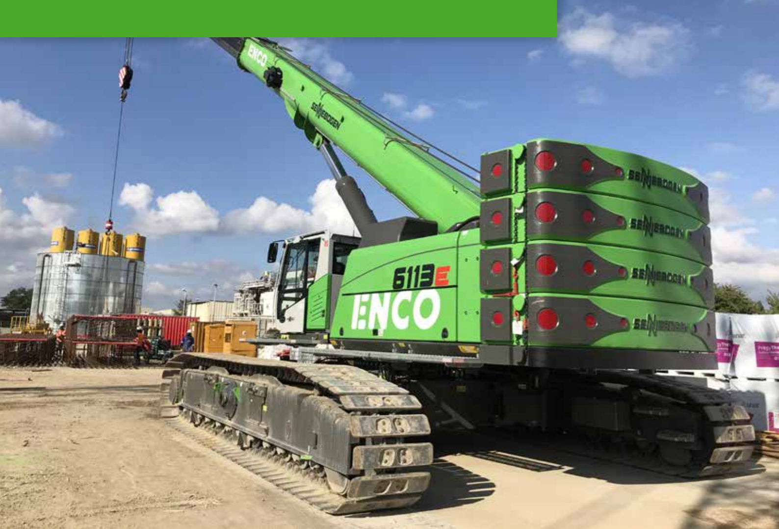
6113 R - moving and positioning large and heavy components in civil engineering; France 6113 R - große und schwere Komponenten verfahren und positionieren im Tiefbau; Frankreich
